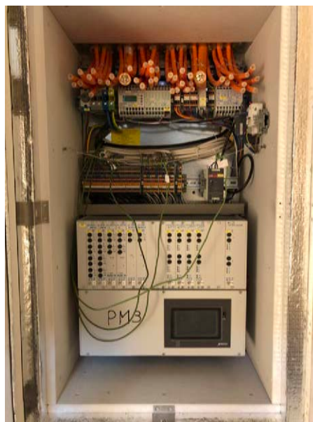
2. Brandschutzverteiler mit eingebauter Sicherheitsbeleuchtungsanlage – vor der Brandprüfung
