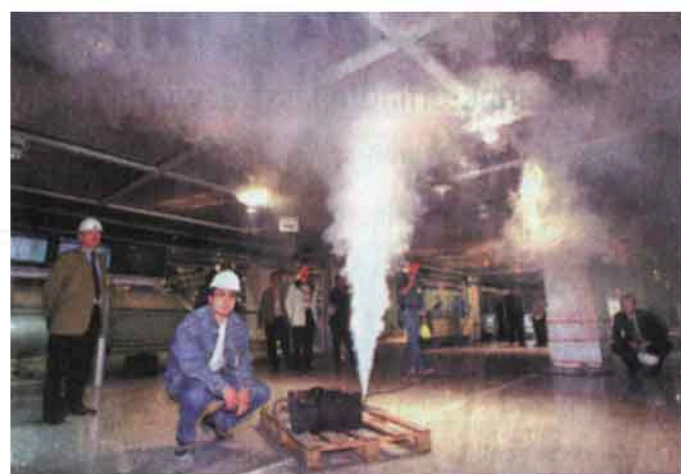
Bis zum Schluss wird – wie hier Anfang der Woche – von Ingenieuren die modernste Brandmeldeanlage der Welt getestet.
